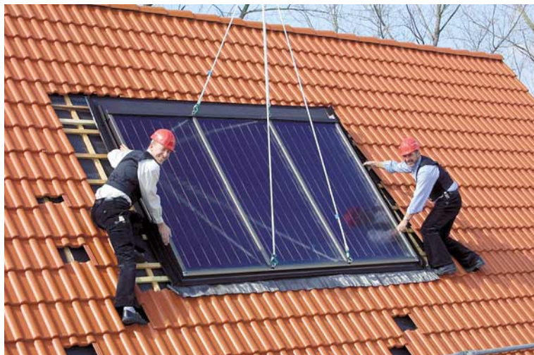
← Montage eines Thermokollektors TK 6 mit dem Hochkranservice zum Festpreis. Im Normalfall bedarf es keines Installateurs auf dem Dach.
